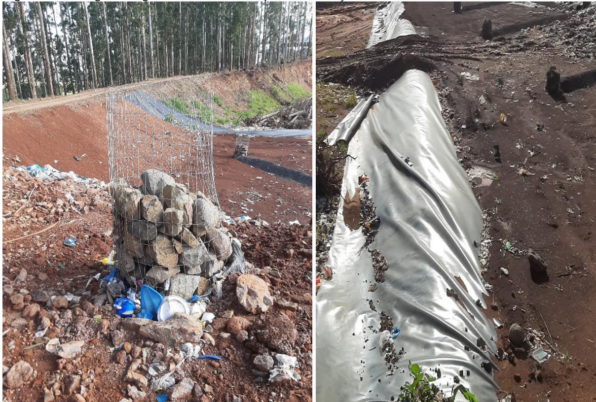
Figura 8: Drenagem de gases e manta de impermeabilização – 06/2020.
