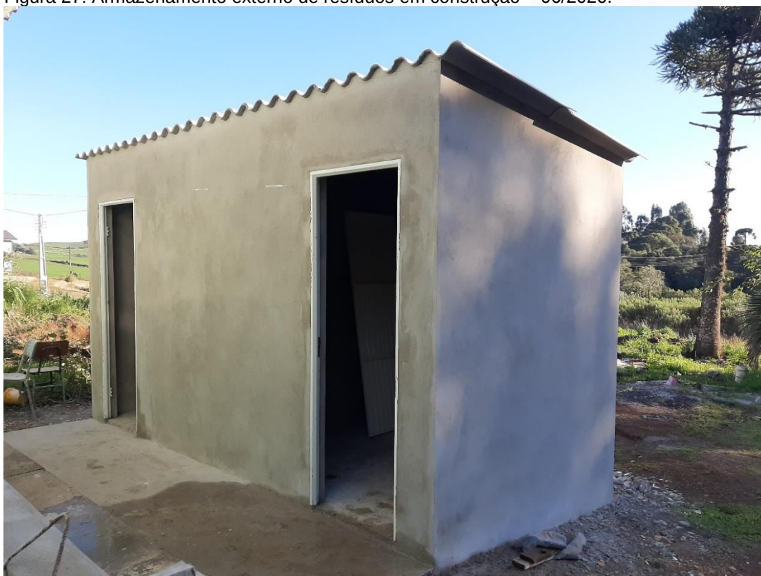
Figura 27: Armazenamento externo de resíduos em construção – 06/2020.
